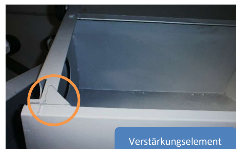
Riss an einer Stahlblechstufe
