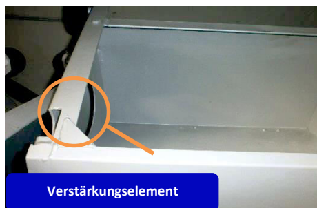
Riss an einer Stahlblechstufe
